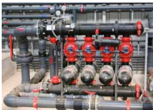
Fig. 5.3 Sistema de filtrado de un cabezal de riego por goteo
