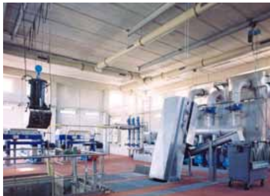
Fig. 2.12 Pretratamiento en la EDAR de Torre Pacheco
