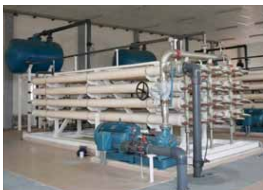
Fig. 3.10 Desaladora de aguas de drenaje de la CRC en el Mojón
