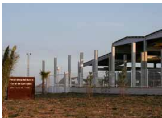
Fig. 2.19 Planta desaladora de San Pedro II
