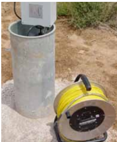
Fig. 4.19 Sistema de medición del nivel freático
