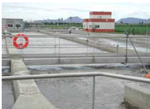
Fig. 2.14 Reactor biológico de la EDAR de Torre Pacheco
