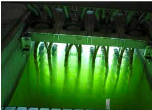
Fig. 2.15 Tratamiento con ultravioleta en una EDAR
